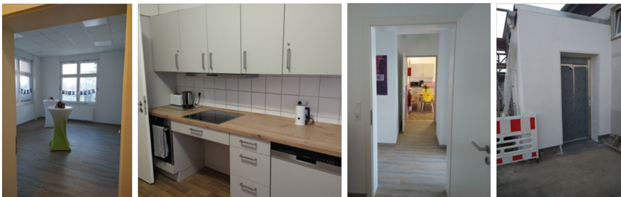
Zusätzlicher Gemeinschaftsraum im EG, unterfahrbare Küche im 1. OG, Übergang zwischen Anbau und Bestandsgebäude, Aufzug mit Zugang zur Dachterrasse. Quelle: ifs
